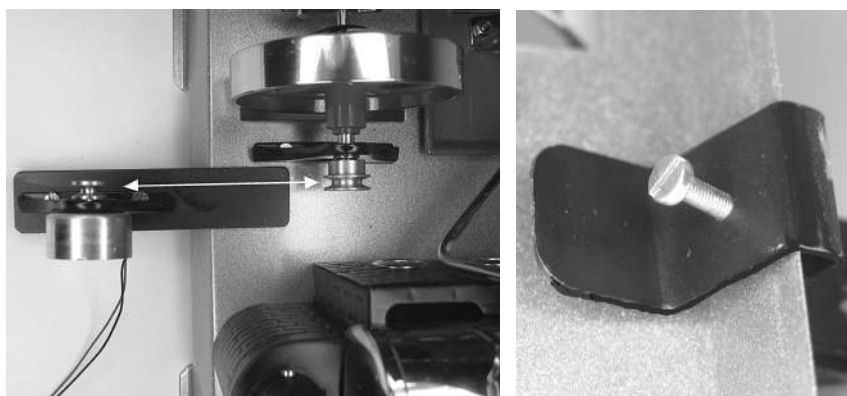
Abb. 3.27: Generatormontage: a) Riemenräder in der Flucht b) Klemmschraubung, unten an der Grundplatte
